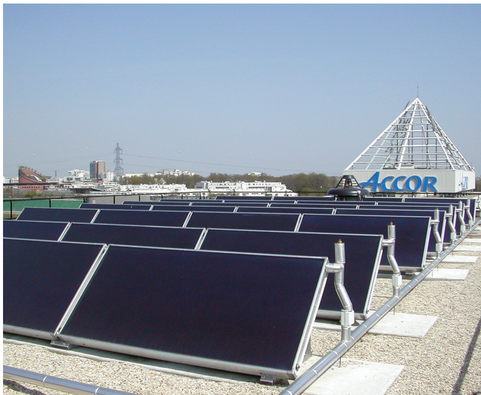
► Capteurs solaires Vitosol 200-F installés sur toiture-terrasse
